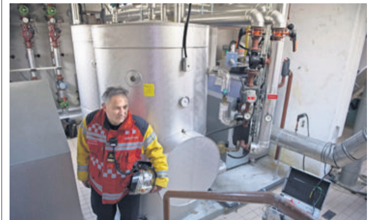
La chaufferie de l'immeuble visitée en urgence par les pompiers du SIS, dont leur capitaine Marc Feuardent. PIERRE ABENSUR
